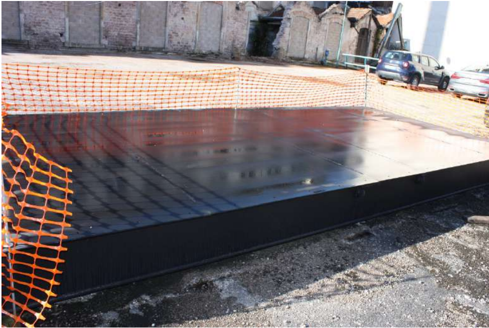
Figure 17 : Nouvelle vanne, stockée actuellement sur la dalle en rive gauche du barrage
